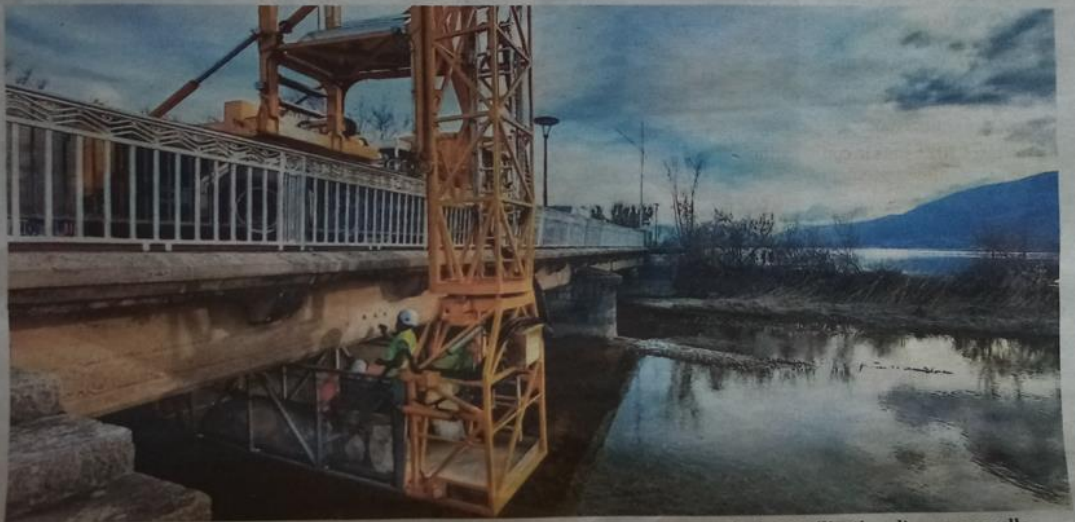
C'est la première fois qu'un sondage de si grande ampleur est réalisé sur un pont aixois. L'utilisation d'une passerelle négative de 14 tonnes et 10 mètres de haut est aussi une première à Aix-les-Bains. Photo Le DL/M.M.
